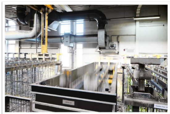
Ein Gestellaufzug ermöglicht räumliche Trennung von Bestückung und Verchromungszone (Geisterproduktion) /7/
