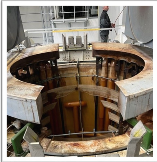
Geschlossener 40.000 l Reaktor zur Verchromung von Ventilkugeln für Pipelines /5/
